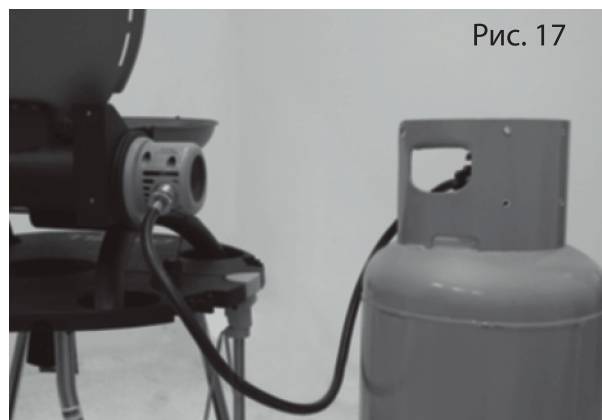
Подключение напольного газового баллона
